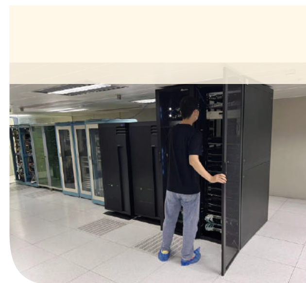
中心机房网络设备巡查
